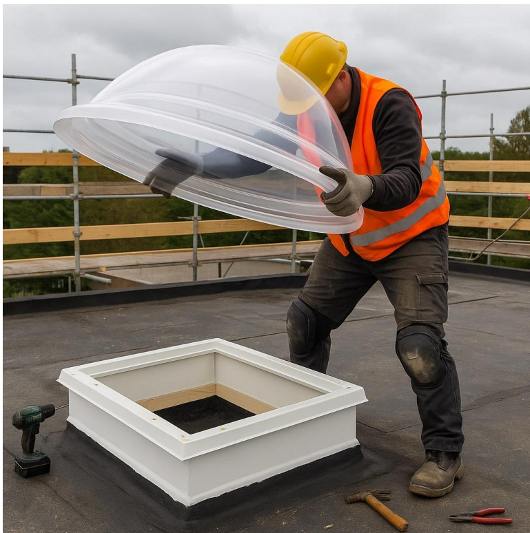
Nicht passende Sanierungslösung ©ChatGPT
